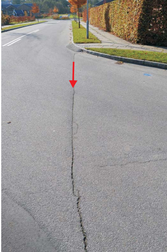
Kold samling fra udførelse af tilslutning grundet dårligt håndværk.
